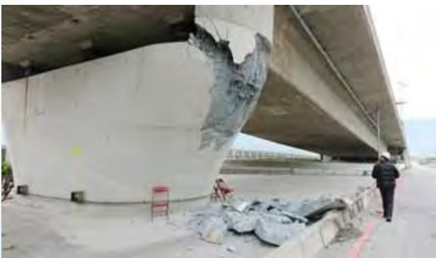
(c)花蓮大地震-七星潭橋[4]
