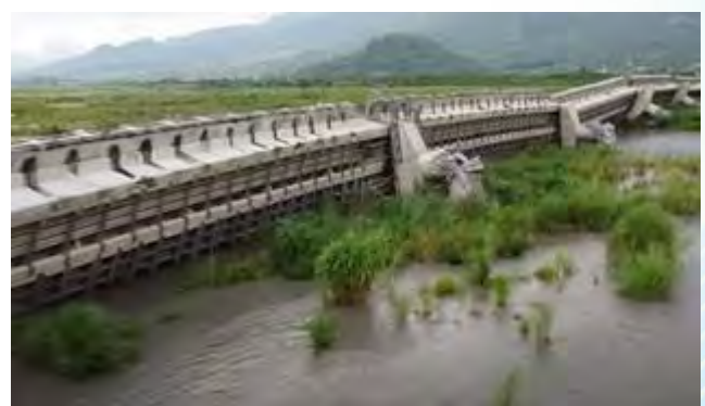
(d)台東大地震-高寮大橋[5]
