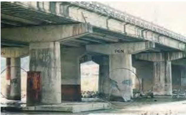
(a) 921 大地震-東豐大橋[2]
