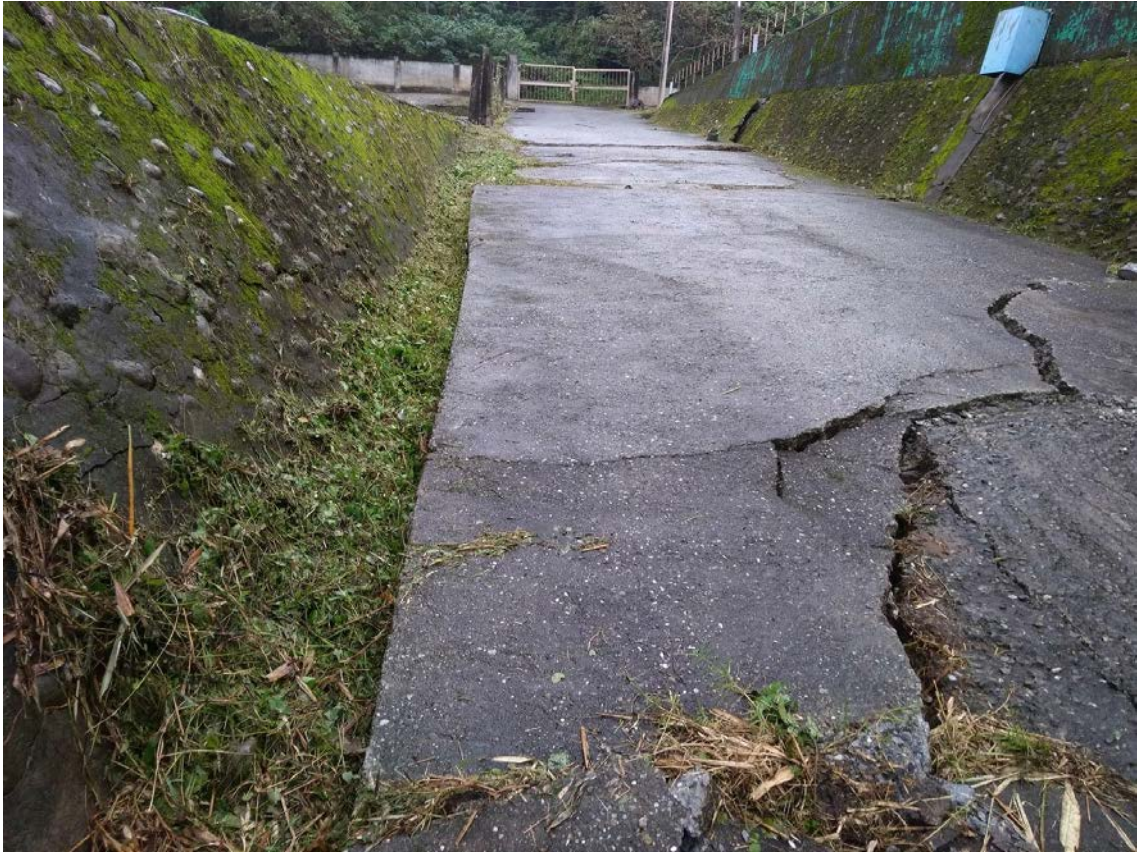
圖 2-1-1-26、尚志淨水廠坡道邊坡向西推擠破裂，向東拍攝。劉彥求攝。
