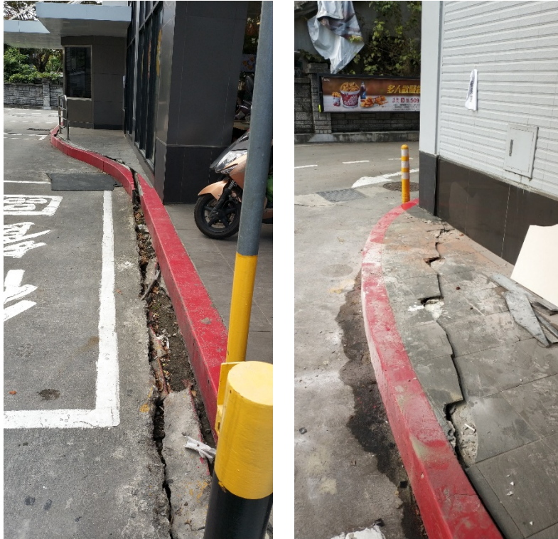
圖 2-1-2-7、明禮路旁之大樓邊緣裂隙。黃志遠攝。
