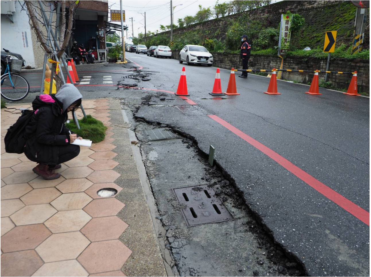
圖 2-2-8、國盛七街水泥溝渠與道路間之破壞現象。莊釗鳴攝。
