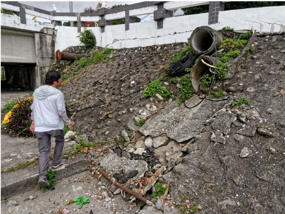
圖 2-1-1-35、忠烈祠前，尚志橋下河堤受破裂向外推擠，水管遭壓扁，此處為過去可觀察到斷層潛移現象位置之一，也是 1951 年地表破裂位置附近。劉彥求攝。
