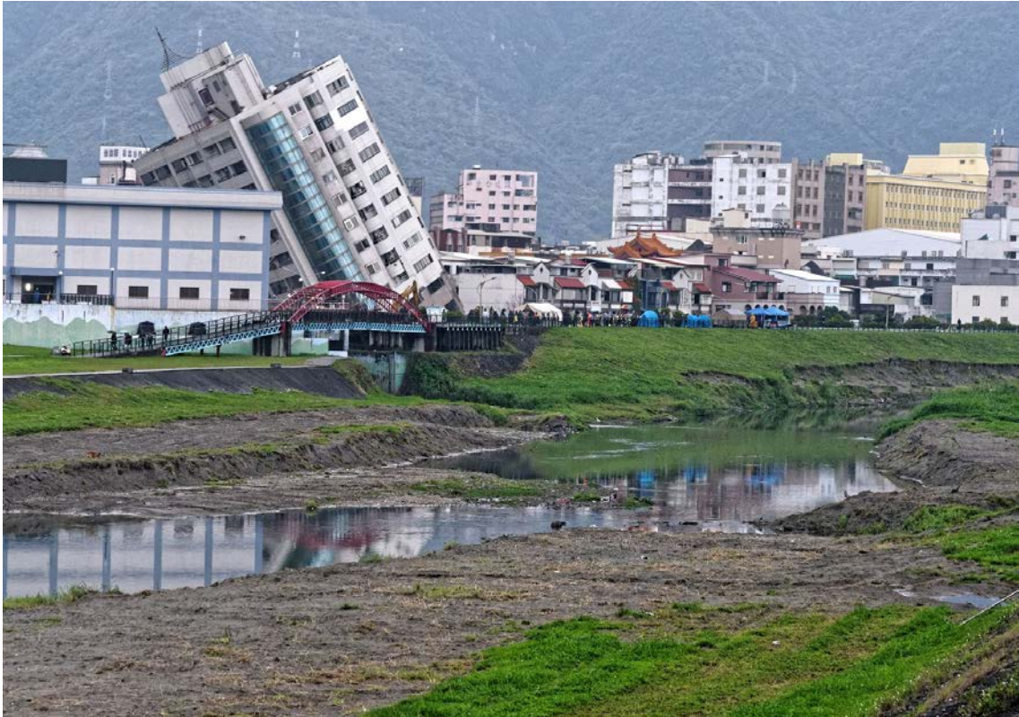
圖 2-2-2、水門至國盛八街之間，美崙溪兩側河堤內發生側潰現象，河岸邊沉積物塌陷、下滑甚至流動向河道內，堤防與水門也出現局部開裂破損情形。劉彥求攝。
