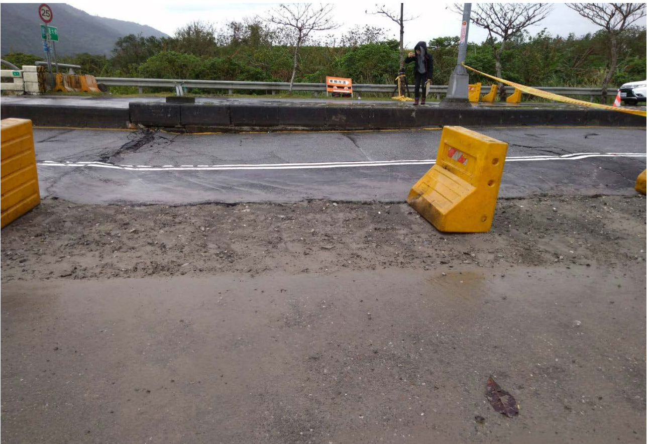
圖 2-1-3-1、花蓮大橋靠西半側橋台附近呈現平行橋台下陷，下陷約 20 公分，寬度近 9 公尺（向南拍攝）。劉彥求攝。
