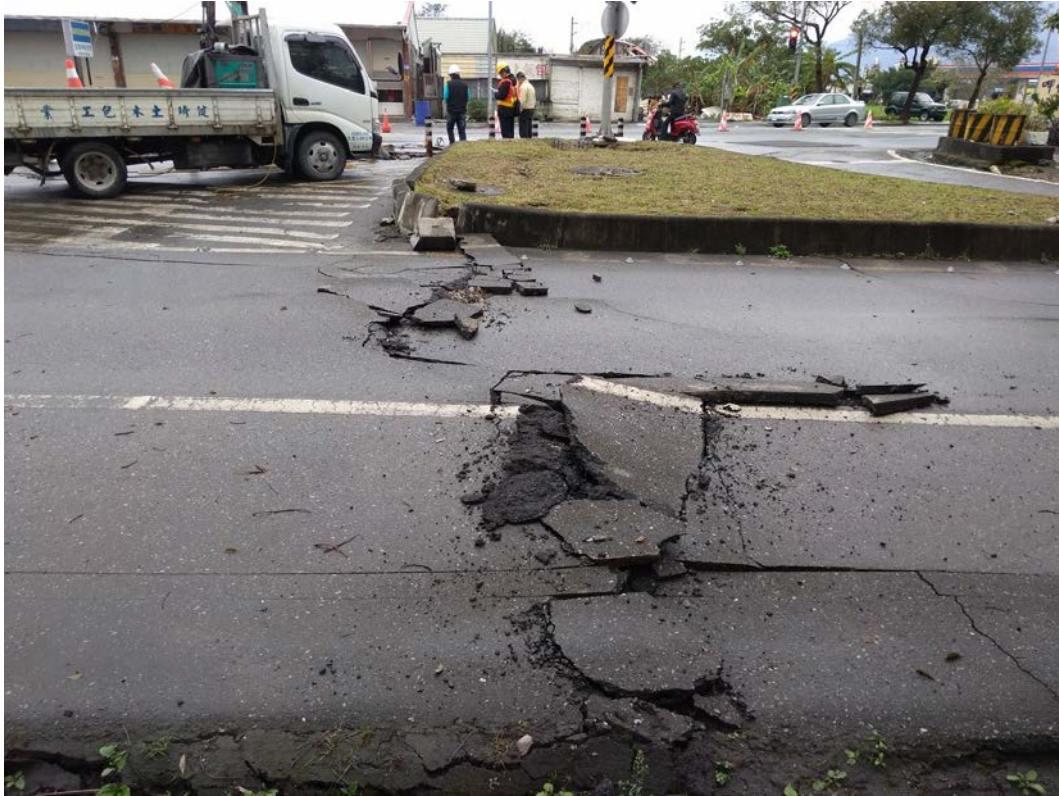
圖 2-1-1-20、地表破裂向南穿出舊花師，造成府前路與分隔島東側抬升，向南拍攝。劉彥求攝。
