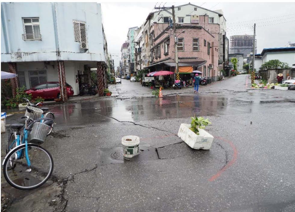
圖 2-1-2-34、廣東街與博愛街口破裂，有一組 N36^{\circ}E 方向裂隙，柏油路面局部隆起，另有一組 N66^{\circ}W 方向的張裂隙，於廣東街朝東北拍攝。莊釗鳴攝。
