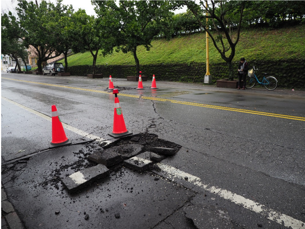
圖 2-1-2-12、明禮路破裂。裂隙可分為 2 組，一組走向為 N55^{\circ}E （與馬路走向垂直），以及另一組沿既有結構延伸至 N6^{\circ}E 破裂（與馬路走向斜交），朝東北拍攝。莊釗鳴攝。
