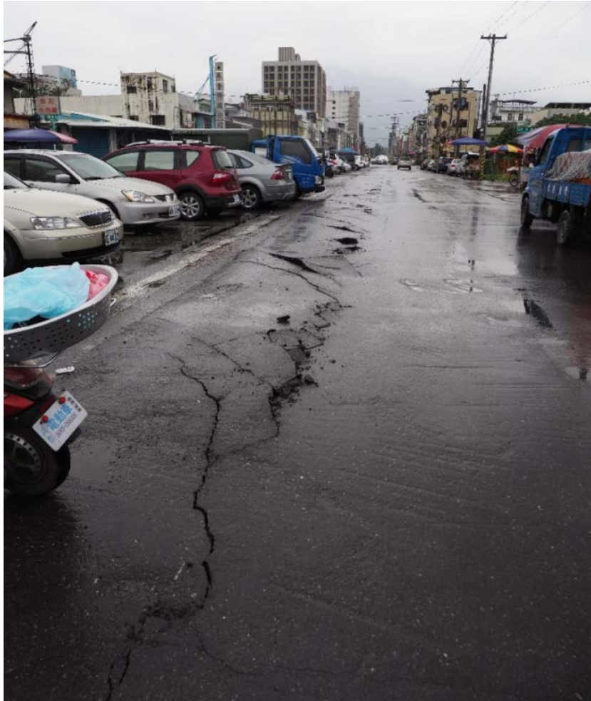
圖 2-1-2-35、重慶路與自由街口之柏油路拱起破裂，經調查拱起下方為舊水溝或疏水道，於自由街朝西北拍攝。陳思婷攝。
