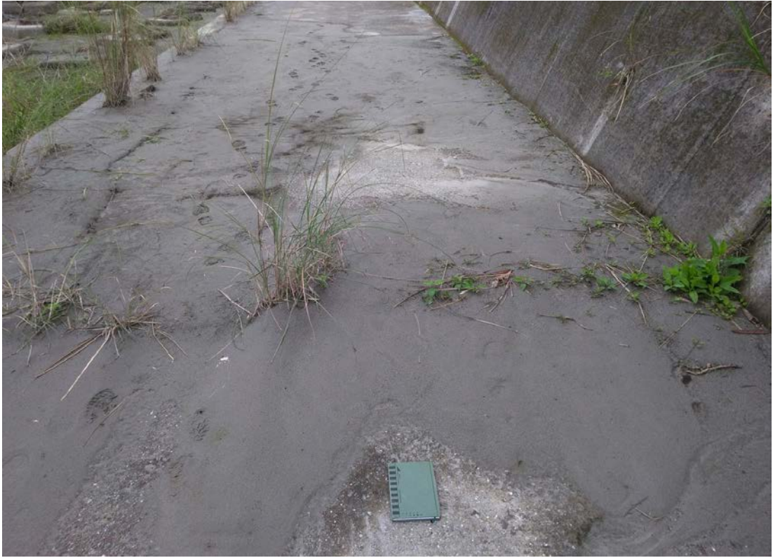
圖 2-1-3-12、崩坎南側堤防結構裂隙擴大並產生連續約 400 公尺噴砂現象，向東北拍攝。劉彥求攝。
