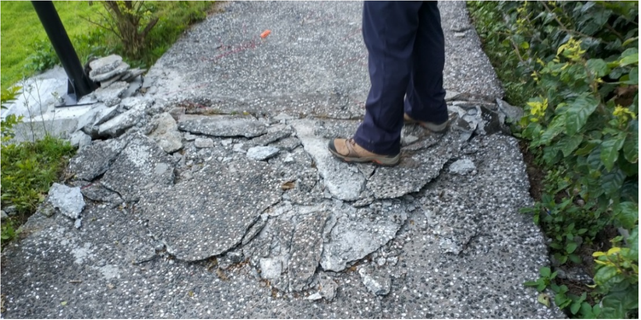
圖 2-2-6、美崙溪兩岸河堤部分地方沿著結構弱面受到些微破壞受損。黃志遠攝。
