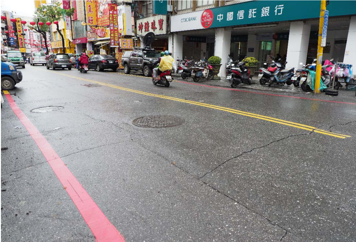
圖 2-1-2-21、公園路 N30°W 龜裂。裂隙未見顯著錯距，朝西北拍攝。莊釗鳴攝。
