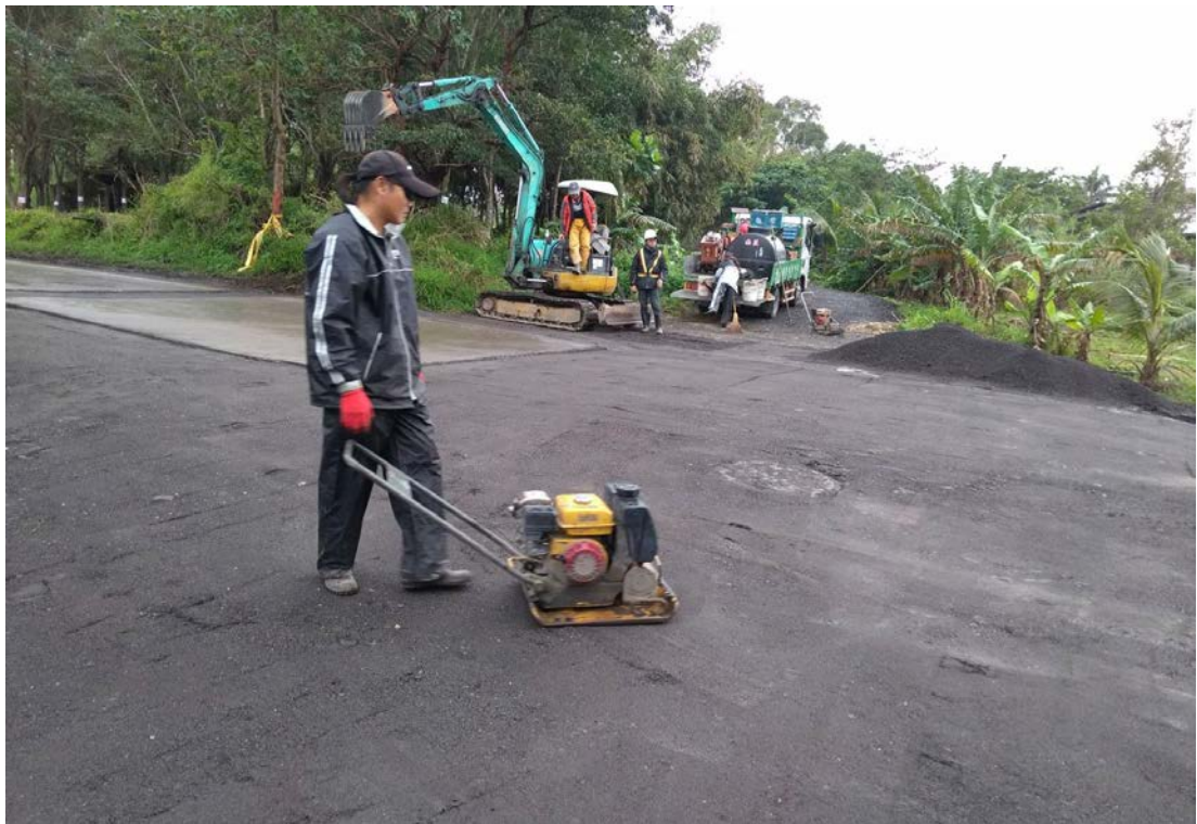
圖 2-1-1-23、新興路與尚志路交叉口東側災損點，調查時地表破裂拱起之部分已推平進行修補，向南拍攝。劉彥求攝。
