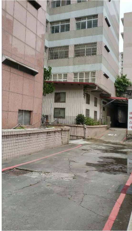
圖 2-1-2-15、花蓮醫院內大樓及路面破損。此處裂隙與 1951 年地震地表破裂位置相近。黃志遠攝。
