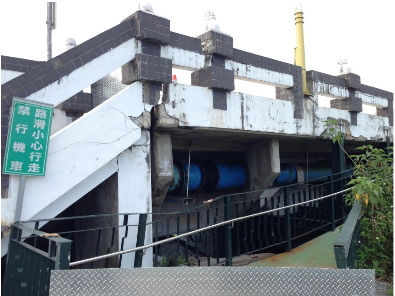
圖 2-1-2-2、林森路尚志橋下橋樑裂開，下方輸送水管也遭到毀壞。黃志遠攝。
