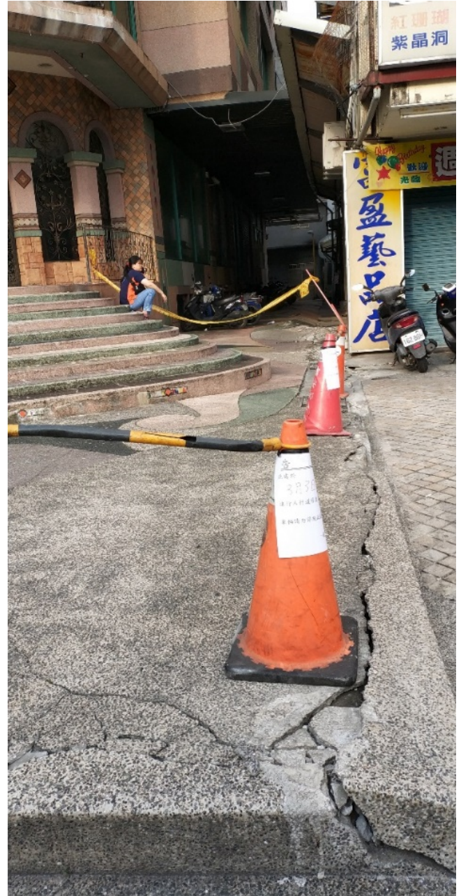
圖 2-1-2-11、中央市場大樓前緣拱起破損。黃 志遠攝。
