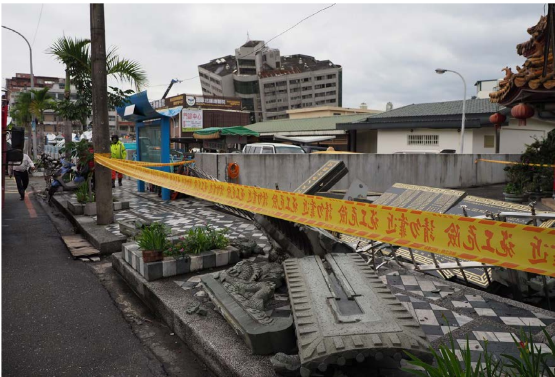
圖 2-2-3、國軍花蓮總醫院周邊道路開裂與建物傾倒與破損情形，據地方耆老表示 1951 縱谷地震發生時，附近亦發生沉陷現象。莊釗鳴攝。
