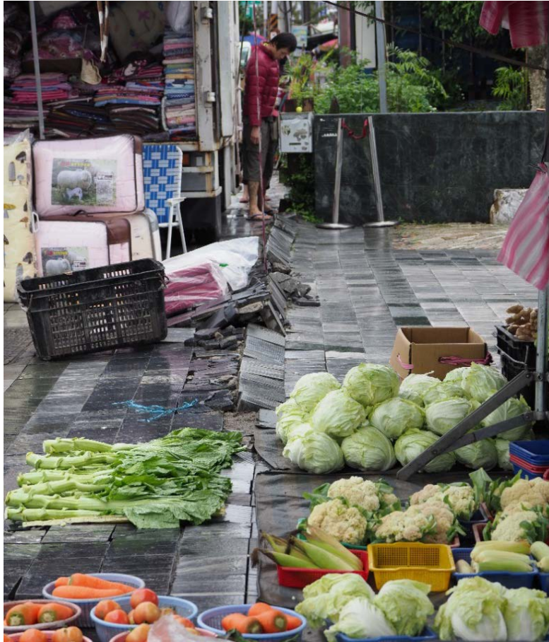
圖 2-1-2-33、重慶路與博愛街口破裂。朝 N70^{\circ}E 延伸，人行道磚上拱，朝東拍攝。莊釗鳴攝。
