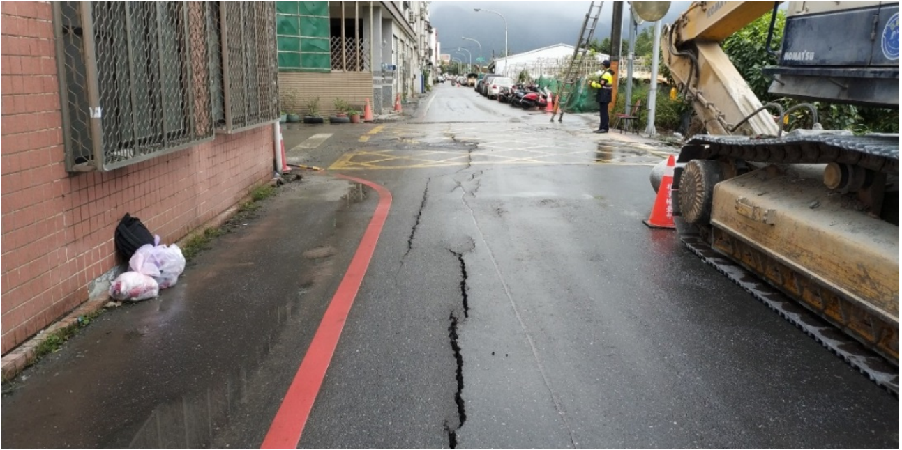
圖 2-2-12、國盛八街靠房屋一側之沉陷造成道路連續龜裂，照片向西北拍攝。黃志遠攝。
