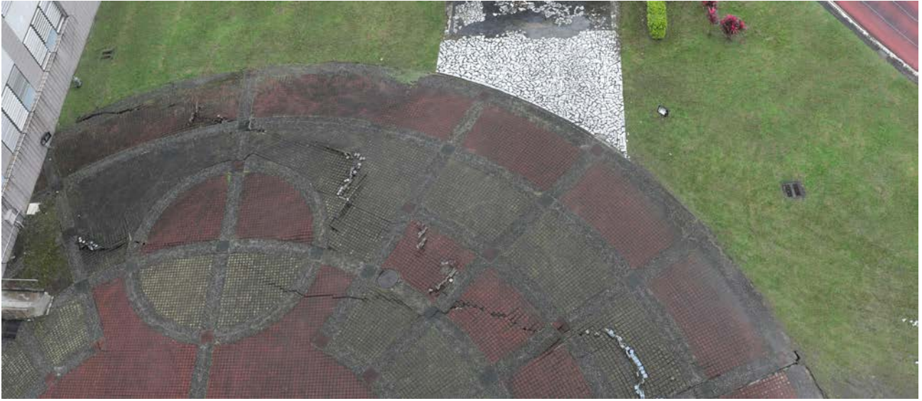
圖 2-1-1-16、另一道地表破裂經涵翠湖西側繞過音樂館，在體育館北側造成地磚形成伸張與擠壓兩組破裂，向東北俯攝。劉彥求攝。
