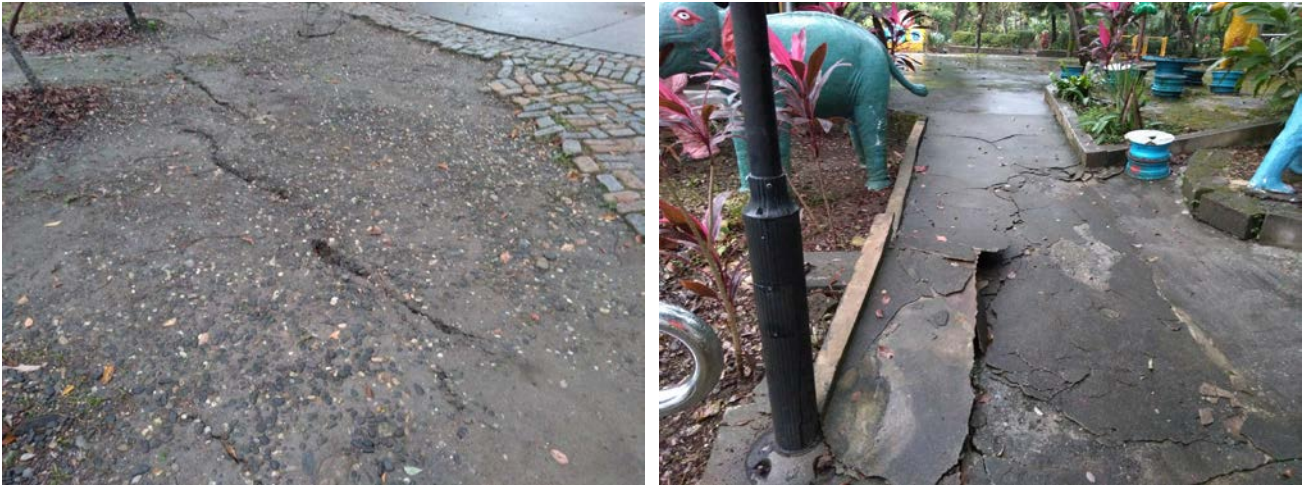
圖 2-1-1-28、忠烈祠北側長春歌舞會地表破裂，地表破裂造成雁形排列裂隙與東側略為抬升。左圖向北拍攝，右圖向南拍攝。劉彥求攝。
