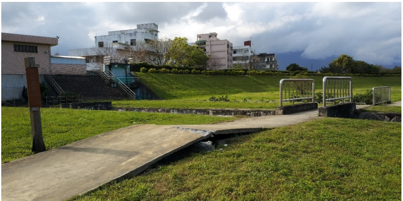
圖 2-1-2-3、美崙溪河濱公園的步道拱起，但兩側草坡未發現有地表變形或地裂現象。黃志遠攝。
