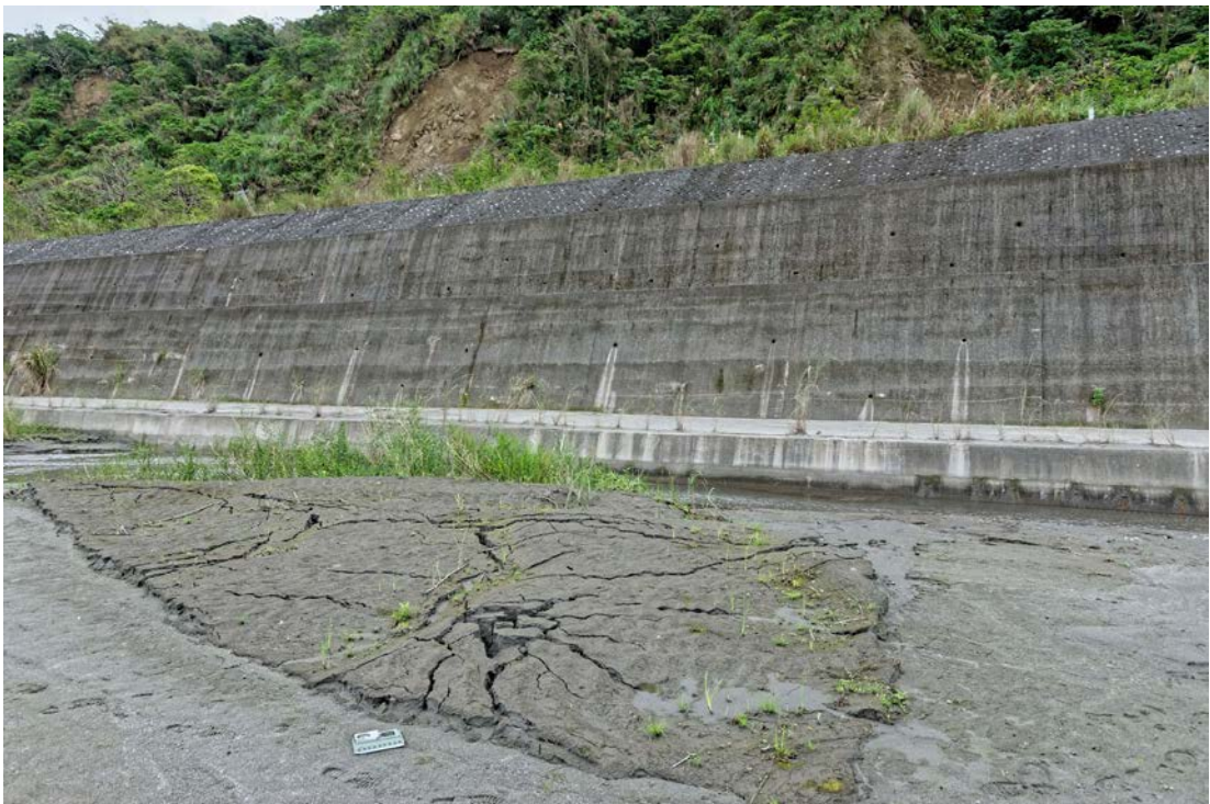
圖 2-1-3-13、崩坎以南，193 縣道 30K 南側堤防旁沙洲噴砂現象。延伸方向約為 N50^{\circ}E ，其約略平行堤防，大小不等，但多受河床水流沖蝕消失，僅餘部分較大者，如此圖中噴砂盾由 3 個鼓起拱裂之噴砂點組成。向東拍攝，東側道路上邊坡產生崩塌。劉彥求攝。
