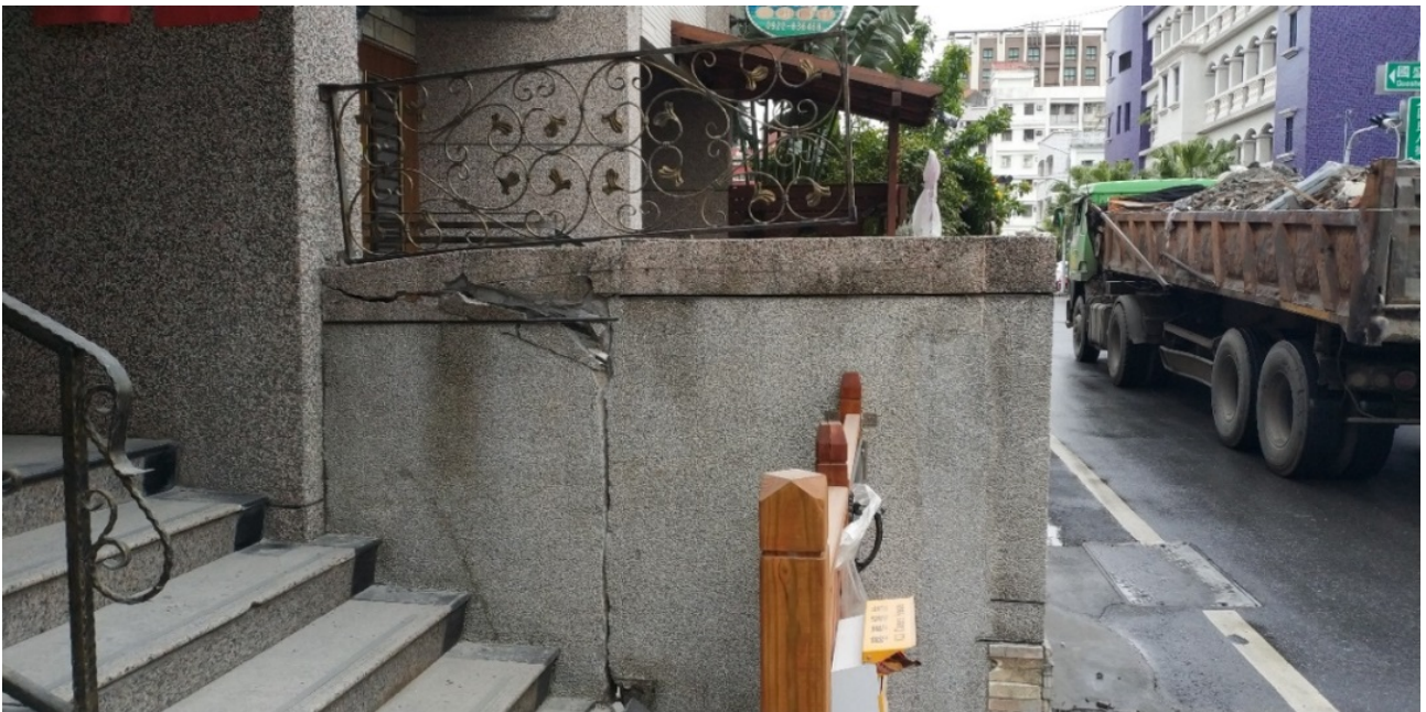
圖 2-2-11、美崙溪西側堤內房屋周邊沉陷，擋土牆錯移破裂，屋外道路水溝蓋旁可見小規模的噴砂殘留。黃志遠攝。
