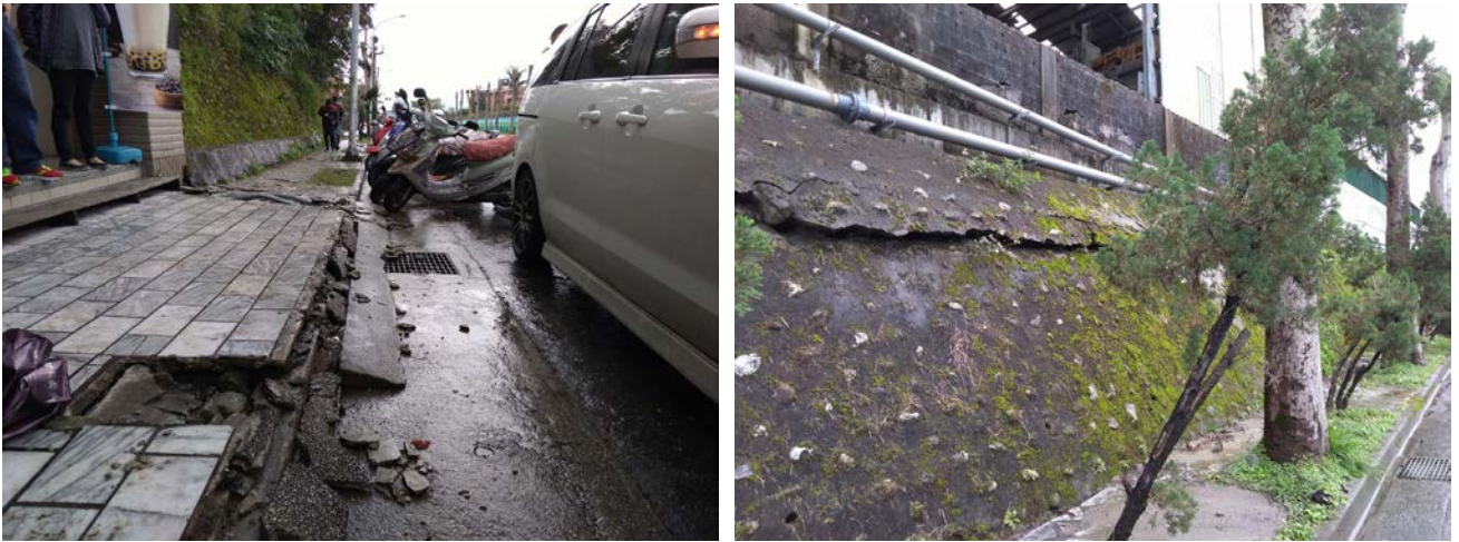
圖 2-1-1-12、華西路東側一道地表破裂於舊花師北側，主要沿道路與建物間隙，以及駁坎等向外推拱抬高。左圖向西南拍攝，右圖向南拍攝。劉彥求攝。
