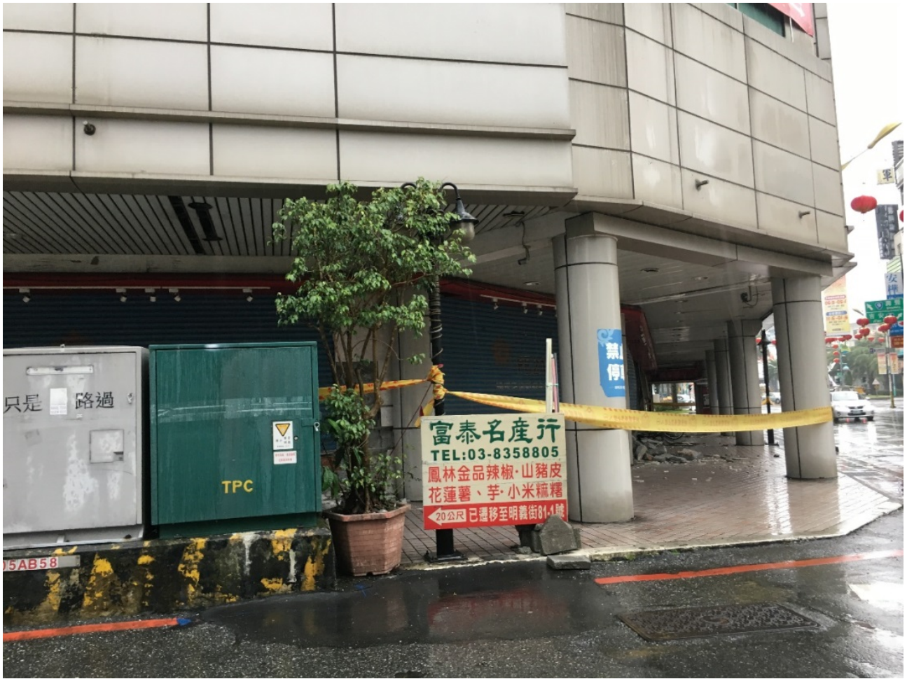
圖 2-3-5、花蓮舊遠百大樓因結構柱破壞而圍起封鎖線。陳思婷攝。
