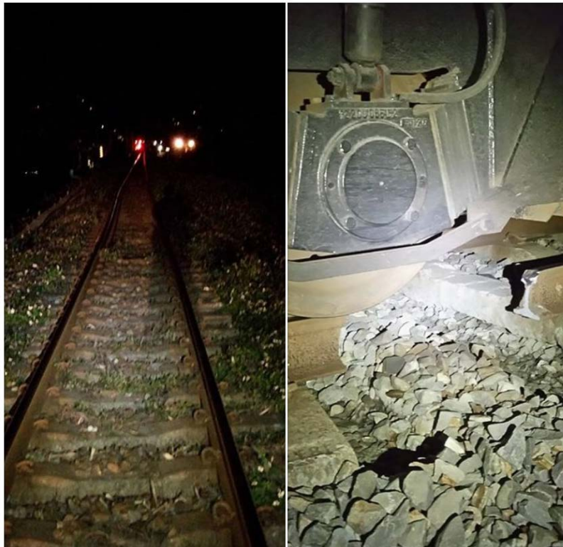
圖 2-1-1-21、花蓮港線 CK4+400 處，復興陸橋附近，軌道扭曲斷軌，引用自臺鐵 FB 官方社群網站“fun 臺鐵”於震後緊急發布訊息。
