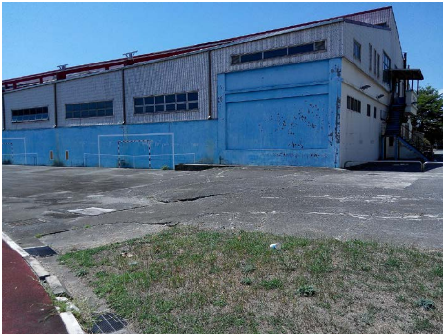
圖 2-1-1-19、舊花師游泳池北側，過去斷層潛移造成水泥地面鼓起與破裂，但此次地表破裂並未造成其變形現象擴大，向東南拍攝。劉彥求攝。
