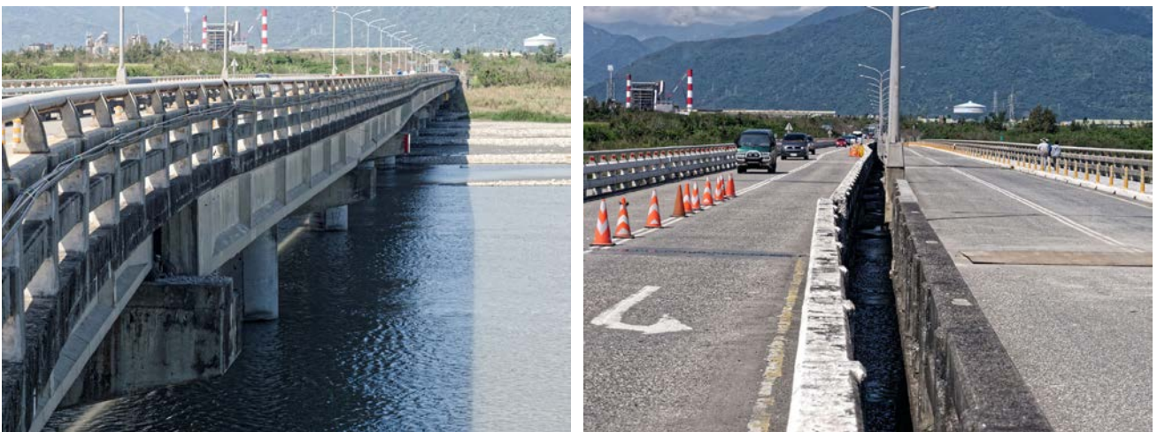
圖 2-1-3-3、由東向西拍攝花蓮大橋東側橋頭橋面相對移動。劉彥求攝。
