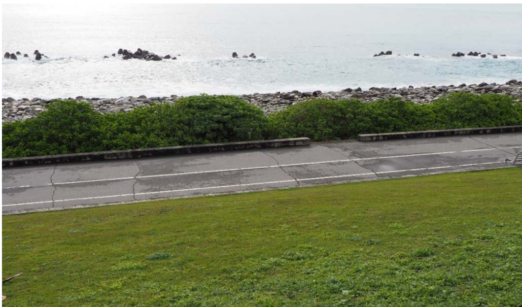
圖 2-1-2-36、南濱公園海堤道路之破裂，裂隙垂直馬路，走向約呈 N40°W。莊釗鳴攝。
