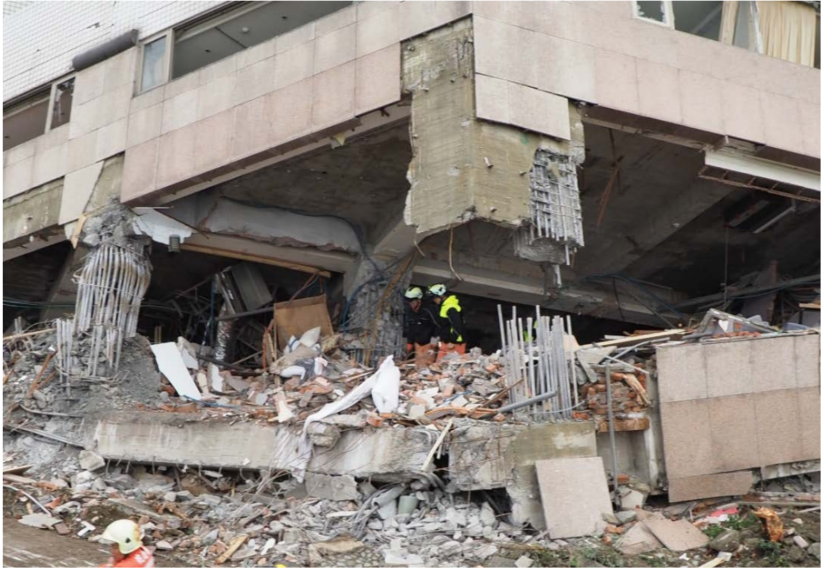
圖 2-3-3、雲門翠堤大樓一樓破壞。莊釗鳴攝。
