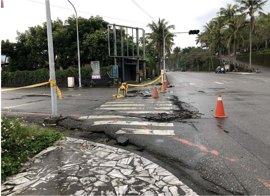
圖 2-1-1-32、尚志路三號橋（國盛四街）與尚志路交叉口附近，向北拍攝。道路受向西推擠，柏油路面拱起破裂。呂貞怡攝。
