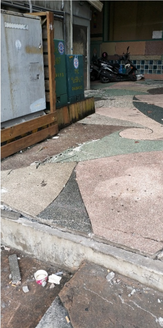
圖 2-1-2-10、公正街附近民宅地板龜裂變形。 黃志遠攝。
