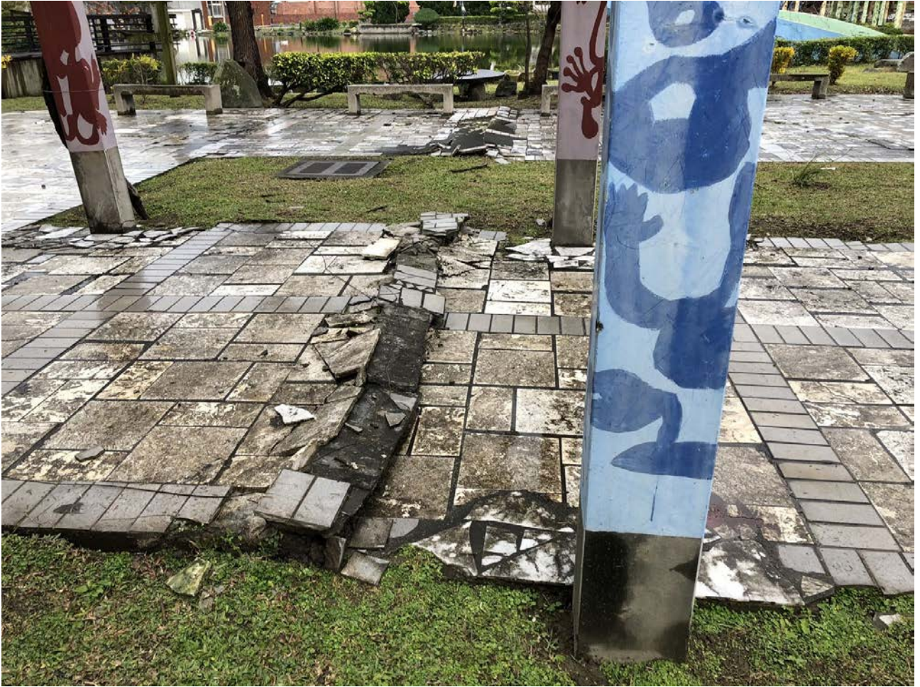
圖 2-1-1-14、地表破裂循轉向 S10^{\circ}-15^{\circ}W ，涵翠湖東側步道大理岩鋪設地磚多處擠壓破裂，此處過去可見斷層持續潛移，向西拍攝。呂貞怡攝。
