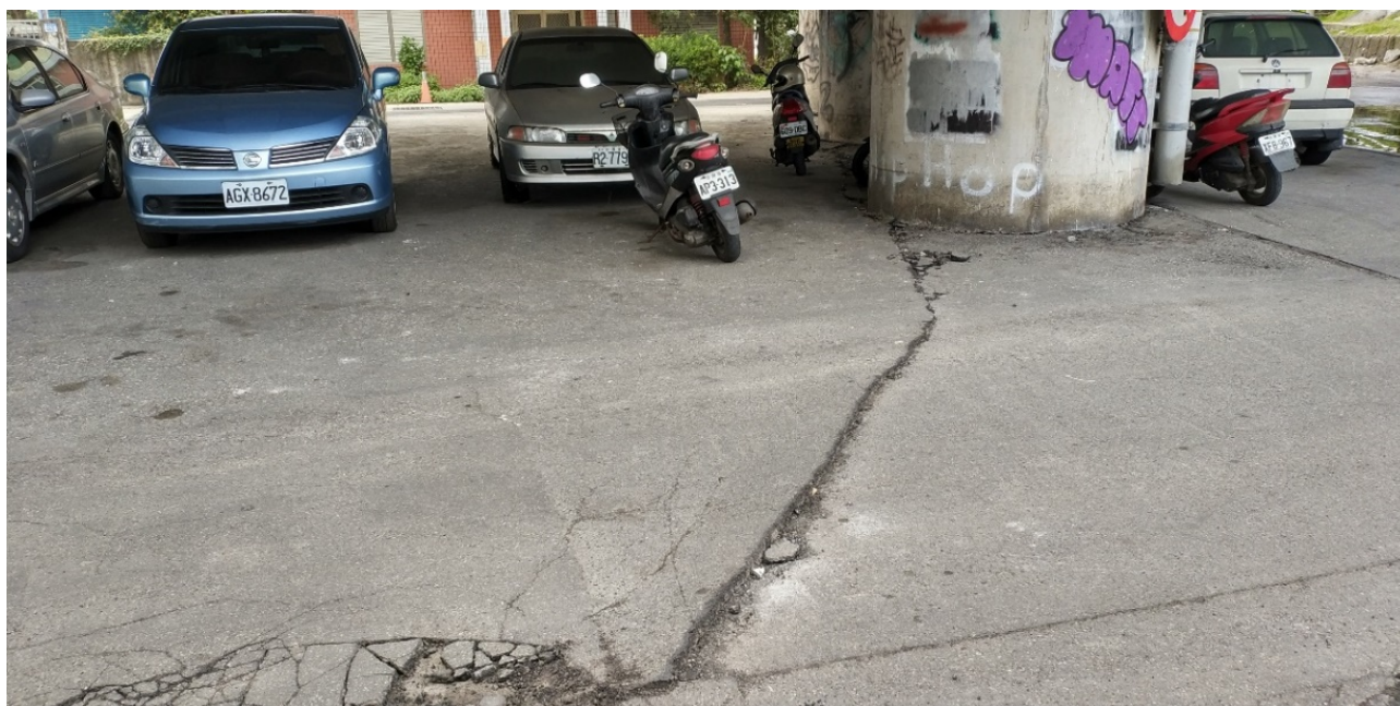
圖 2-1-2-1、林森路尚志橋下水泥地面沉陷約 5 公分。黃志遠攝。
