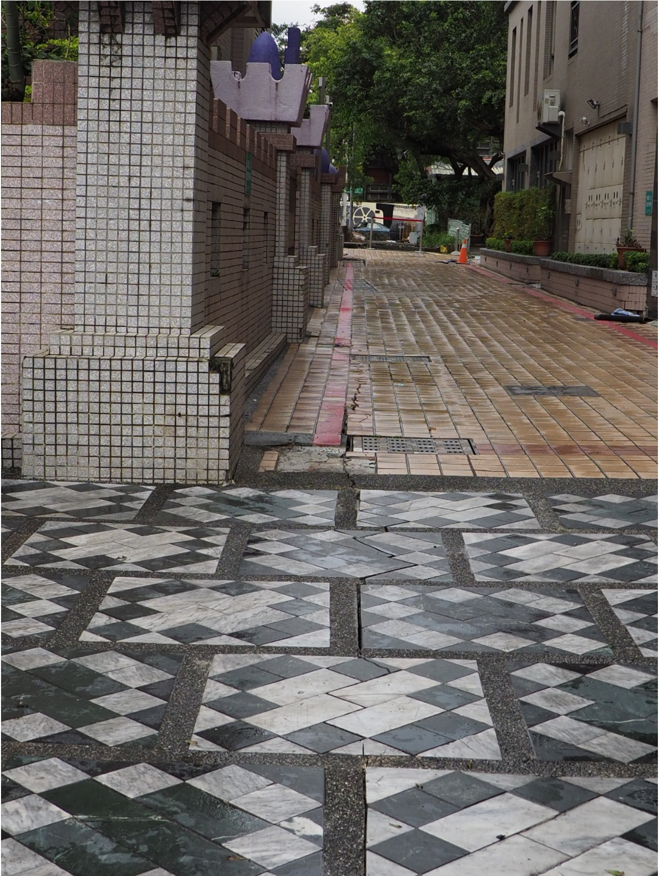
圖 2-1-2-9、地表變形穿過中正路旁商辦混合大樓進入後方公園。莊釗鳴攝。
