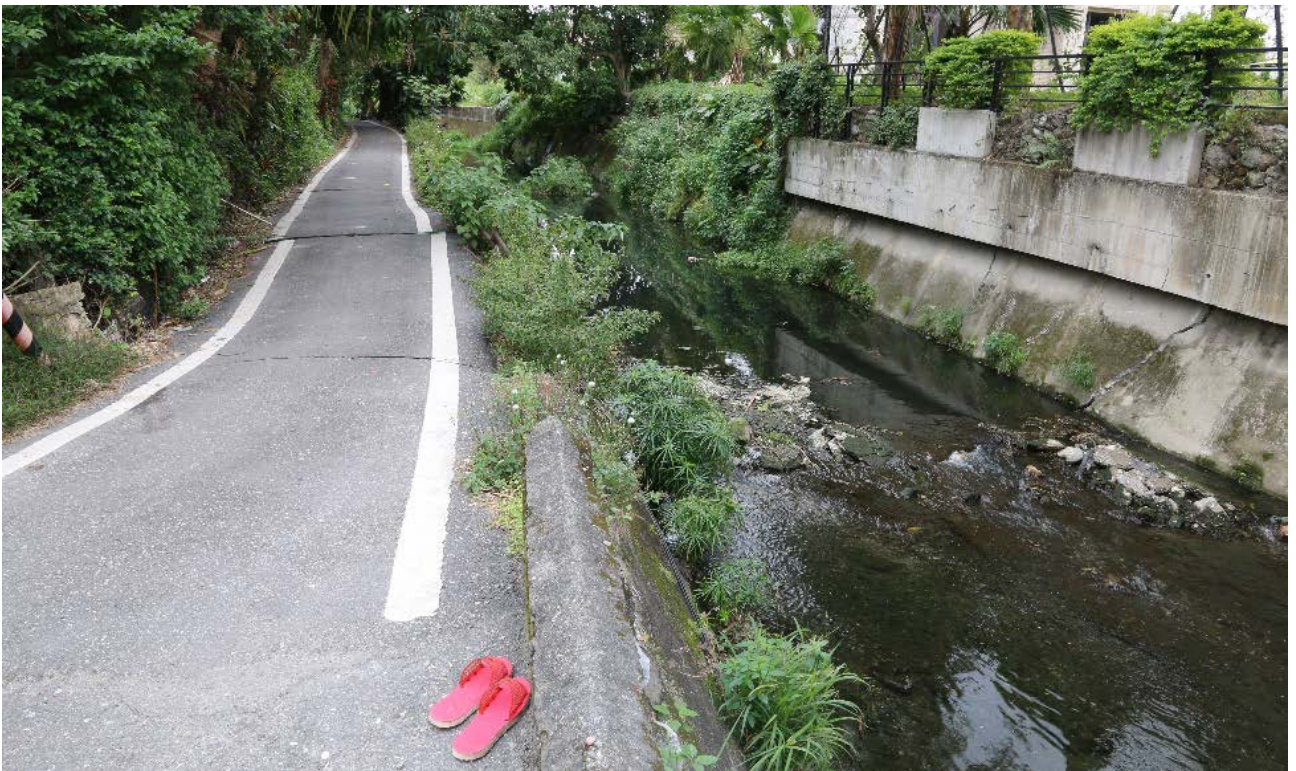
圖 2-1-1-31、新興路與尚志路交口北側河堤旁道路左移現象，累計左移量大於 20 公分。陳柏村攝。
