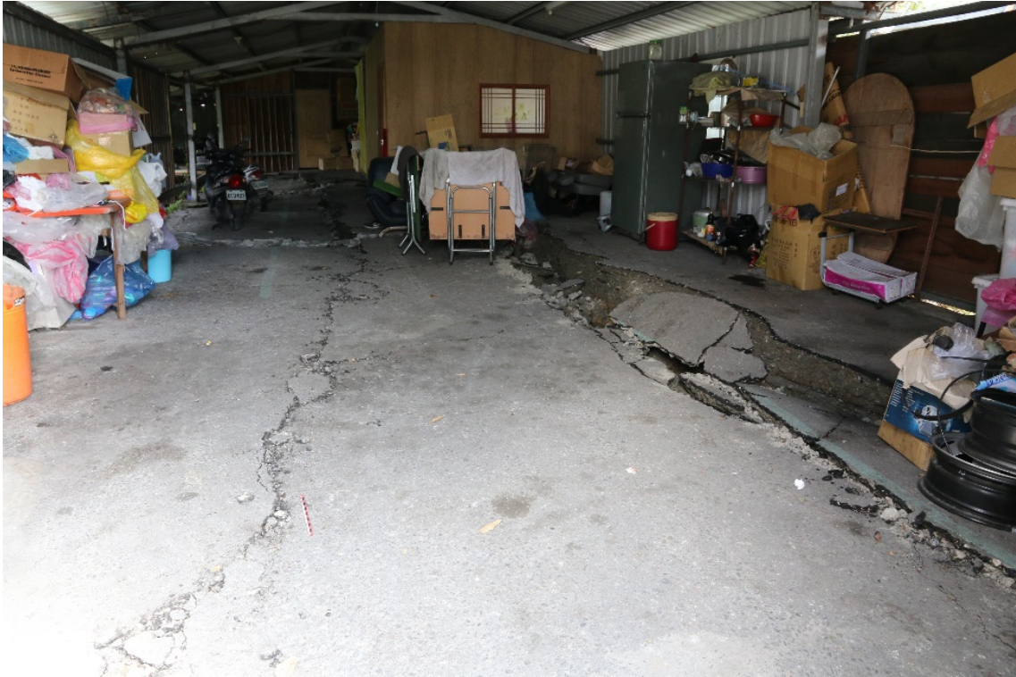
圖 2-1-1-34、尚志路西側路旁民宅內之開裂與陷落。陳柏村攝。
